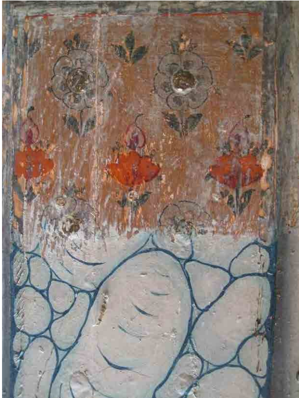
Abb. 592: Bait Salīm al-Quwatlī, Kat. Nr. XVIII-408, Raum im EG des Ostflügels, Steinimitationsmalerei (untere Bildhälfte) verdeckt die ursprüngliche Bemalung, Freilegungsprobe durchgeführt von Shadi Khalil, April 2010
