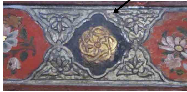
Abb. 513: Bait Nizām (Hintergrund ursprünglich mit grünem Lack bemalt, siehe Pfeil, stark verputzt)
